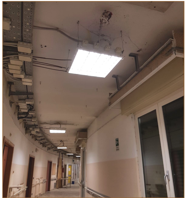
I lavori di adeguamento dell'impianto elettrico al padiglione A dell'ospedale di Malcesine sul Garda
